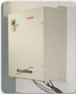
安装在墙壁上的AccuSine有源滤波器
